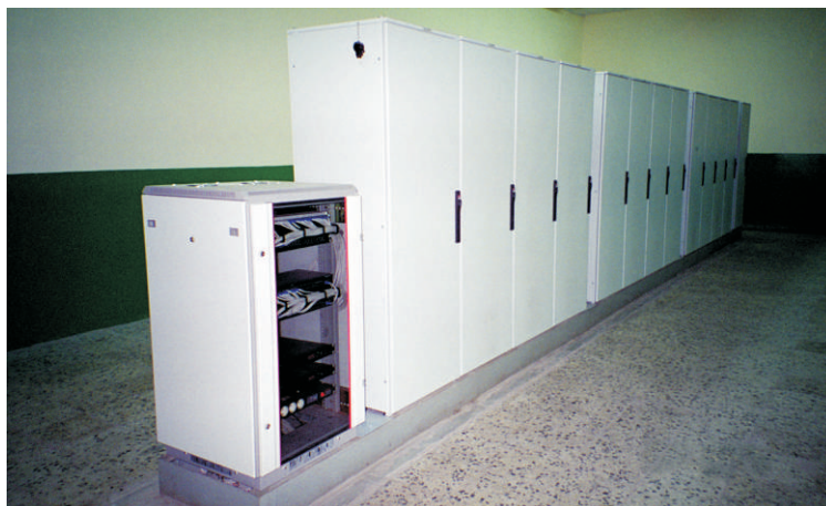
Функциональные шкафы и сетевое оборудование
